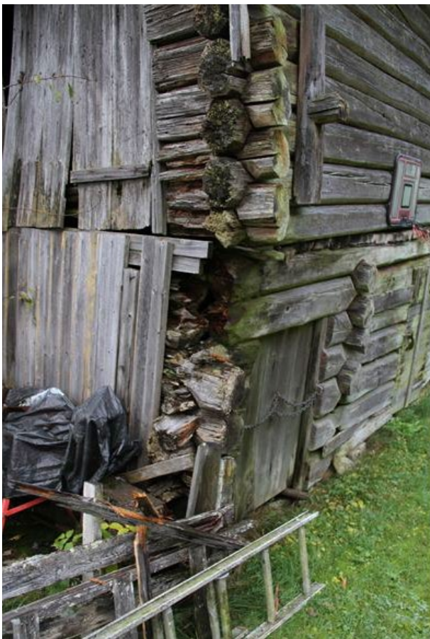
Bilde 31. En bygning som er i ferd med å gå tapt hvis ikke noe gjøres, Slettmoen Nordre.
