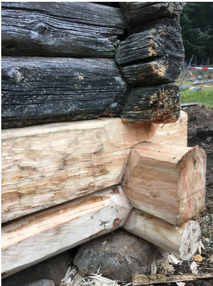
Bilde 35. Et vanlig tiltak på gamle tommerbygninger er utskifting av sviller. Hvis man er ubeldig har råteskadene gått opp i veggene, som her der skadene ikke bare omfatter svilla uten også andre stokken, Hytjanstorpet.
