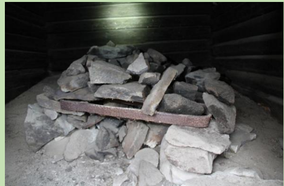
En røysovn som har falt sammen. For å kunne bruke ovnen må denne mures opp på nytt. Foto: Hans Johnsson.
